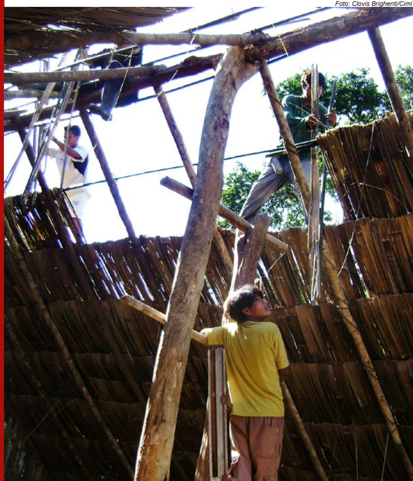
Povo Mbya Guarani, da região Sul do país, durante construção de casa de reza
